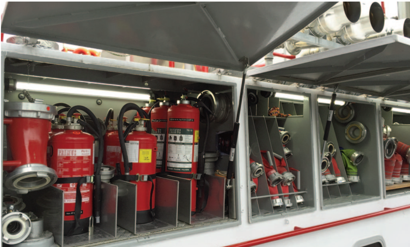
Feuerlöschboot Basel-Landschaft – Ex-Rohrleuchten im Geräte- und Schlauchkasten Bateaux-pompes du canton Bâle-Campagne – Luminaires tubulaires antidéflagrants Fireboat Basel-Landschaft – Explosionproof tube lights
